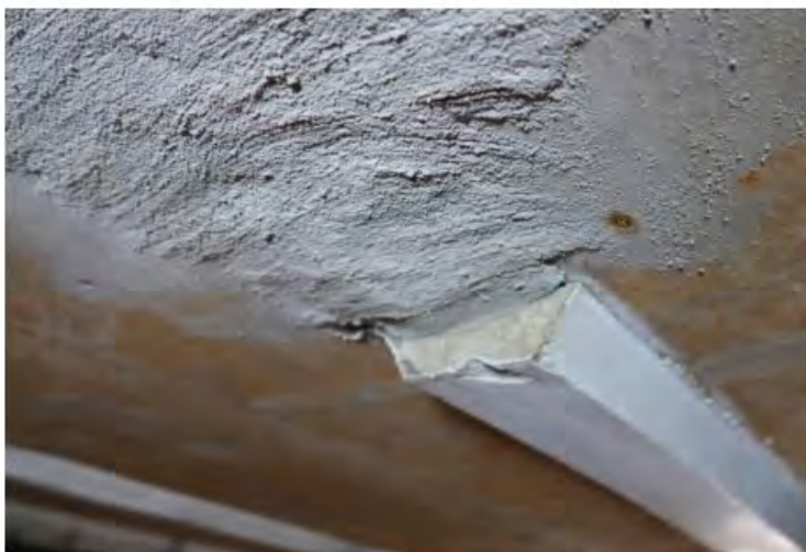
Figuur 4.11: Ontbrekend deel van de omhulling
