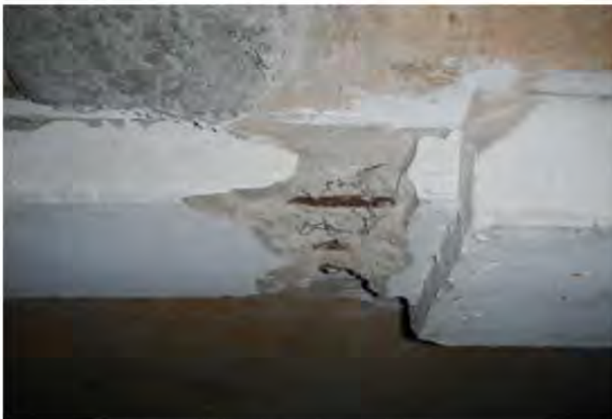
Figuur 4.4: Beschadigde aanstorting (Afbeelding 2-23 uit [09])
