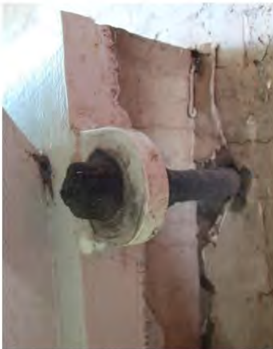
Figuur 5.2: Scheuren in cementgebonden ondersabeling
