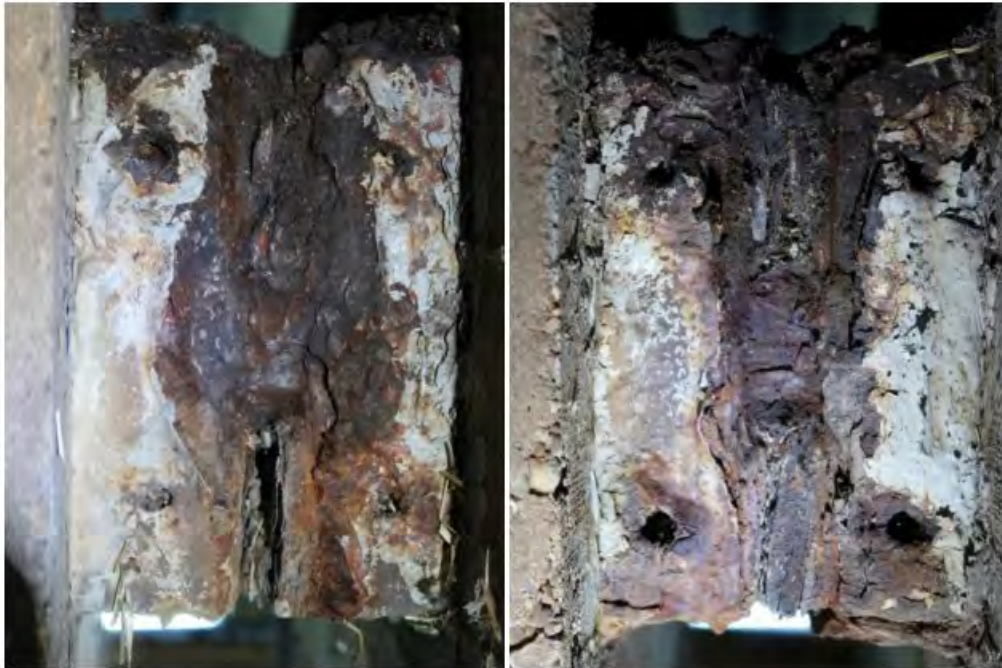
Figuur 5.7: Overzicht scharnier met corrosie
