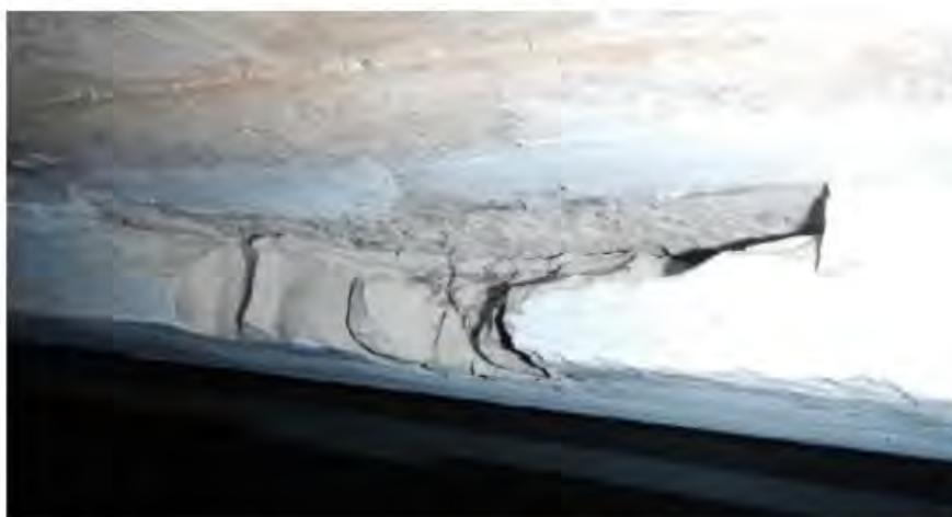
Figuur 4.5: Beschadigde aanstorting (Afbeelding 2-24 uit [09])
