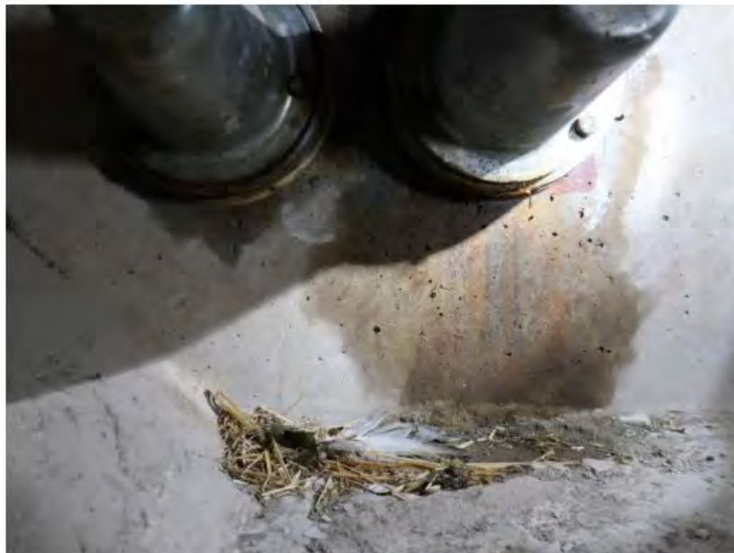
Figuur 5.4: Donkere verkleuring van het beton onder een anker van een dwarskrachtdeuvel
